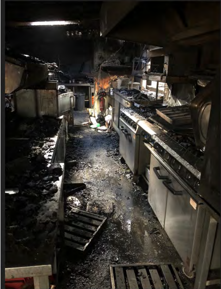
Fire Damage #1.jpg
